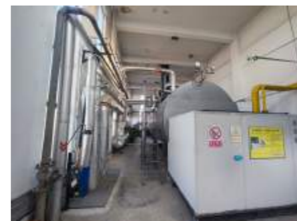
鍋爐房低氮改造
